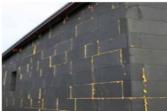
Obr.2 – mezery vyplněné pěnou (nestandardní postup a důsledek nezakryté fasády)
